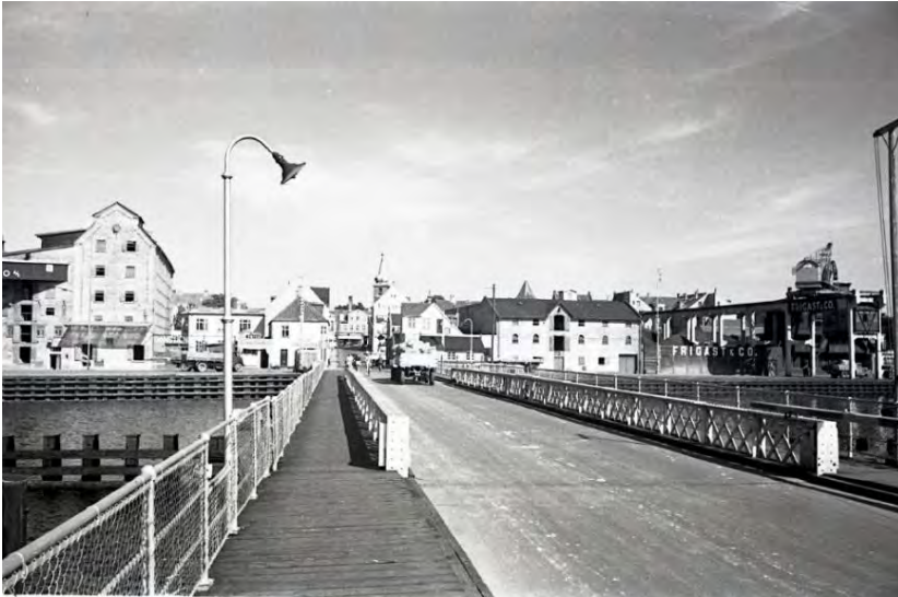
Billedet er taget af svingbroen efter 1933. Kørebanen blev udvidet og der blev placeret ophøjede fortove på hver side af det inderste rækværk. Det yderste rækværk blev trukket ud sammen med fortovet. Kilde: Falsters Egnshistoriske Arkiv. 057-1991_023. Fotograf J. F. Jessen.
